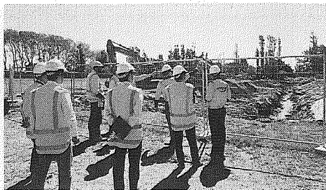
現地で復旧状況を視察
